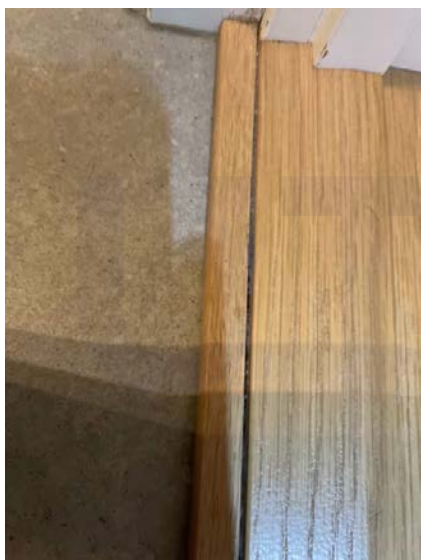
Mangledne tettesjikt ved dør.
