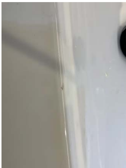
Avskalling på servant.
