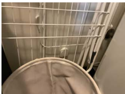
Avrenning fra fordelerskap.
