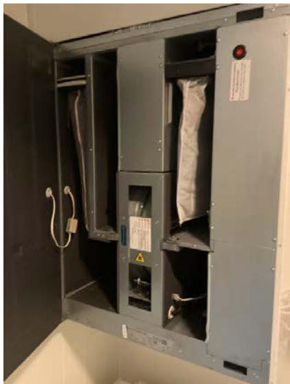
Aggregat for ventilasjon
