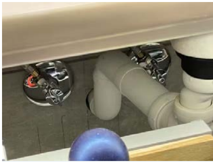
Manglede tetting rundt rørgjennomføring.
