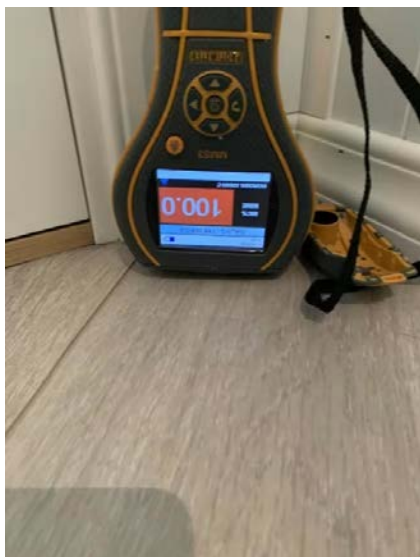
Viser fuktmåling i laminat.
