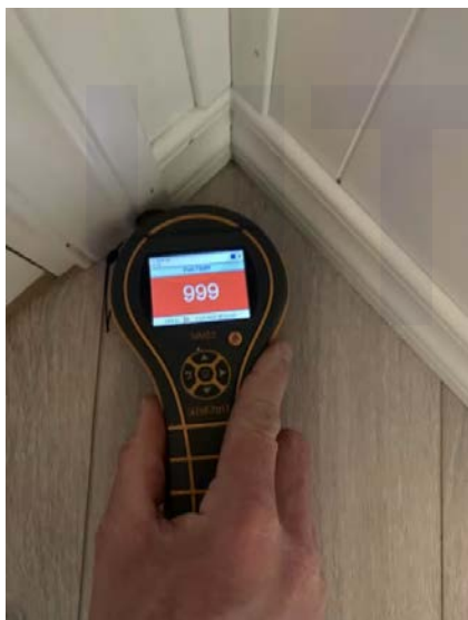
Viser fuktsøk i laminat.
