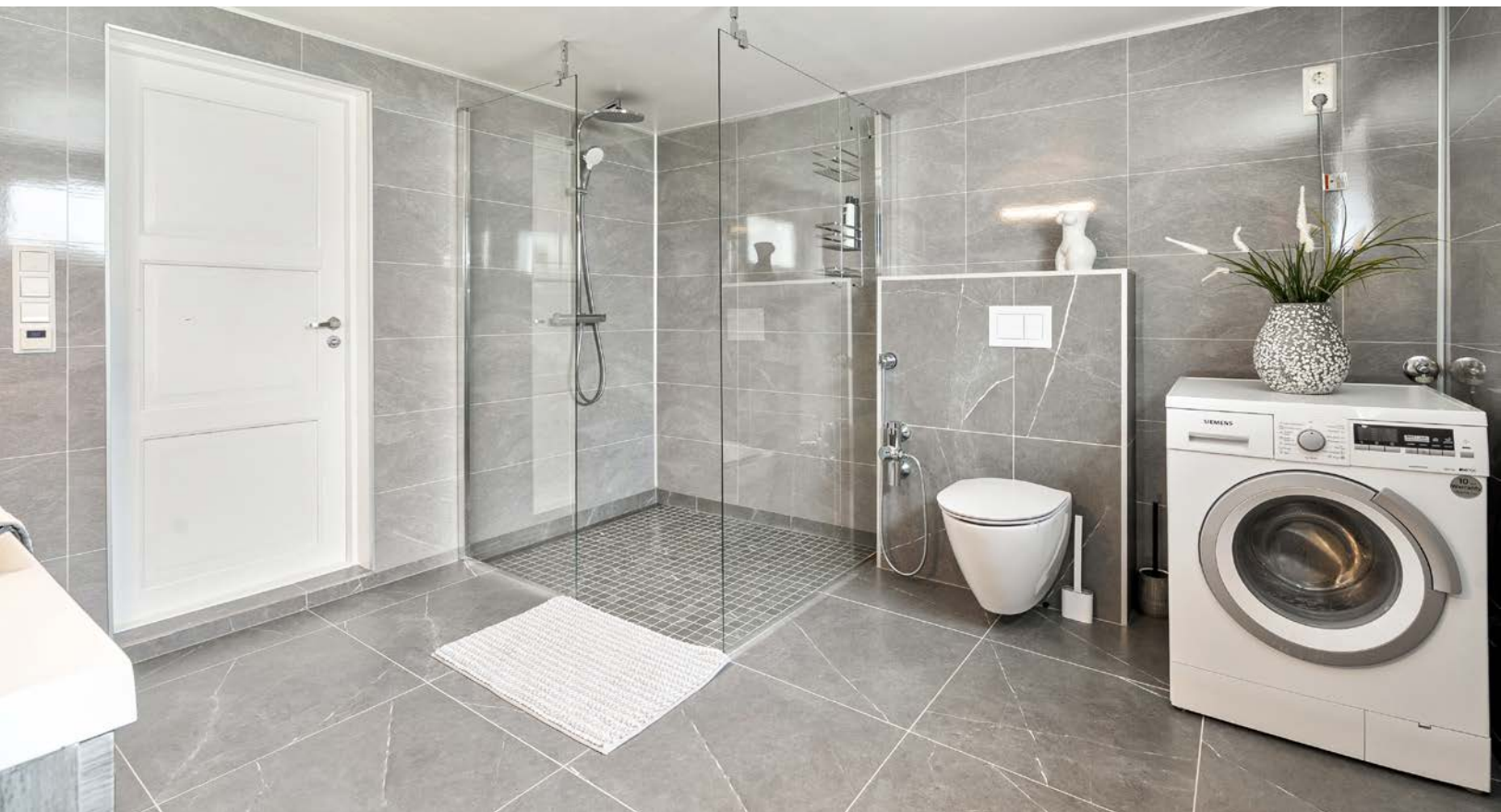
Varmekabler i gulv.
