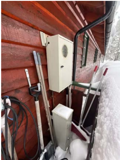
Viser inntaksskap og målerskap utvendig.
