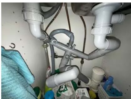
Viser vann og avløpsinnstallasjoner under kum.
