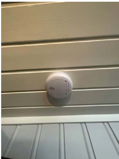
Viser brannvarsler i himling. Anbefales flyttet slik at avstand fra vegg blir minimum 50cm.
