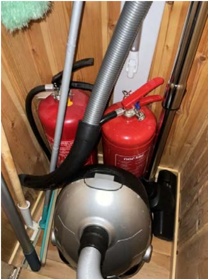
Viser 2 stk brannslukningsapparater.
