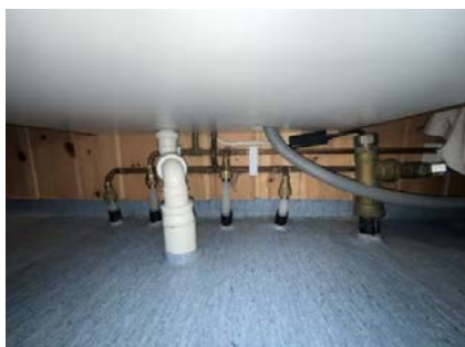
Viser vanninntak, hovedstoppekran, vannrør med rør i rør og kobber fra åpen fordeler plassert på bad og frem til sanitærinstallasjoner på baderom og kjøkken
