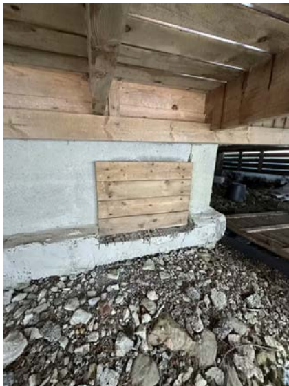
Åpningen til krypkjelleren er spikret igjen.
