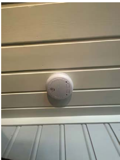
Viser brannvarsler i himling. Anbefales flyttet slik at avstand fra vegg blir minimum 50cm.
