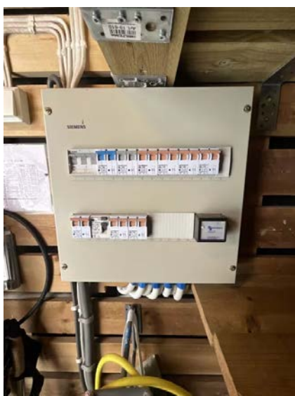
Viser sikringsskap plassert i bod.
