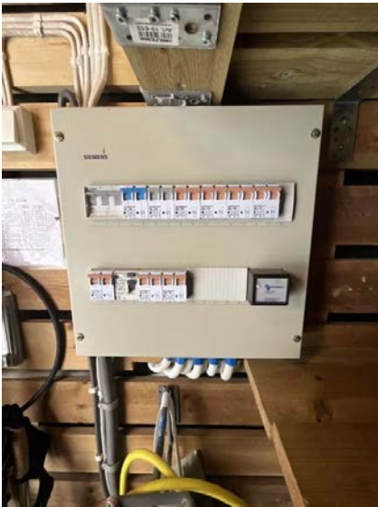
Viser sikringsskap plassert i bod.
