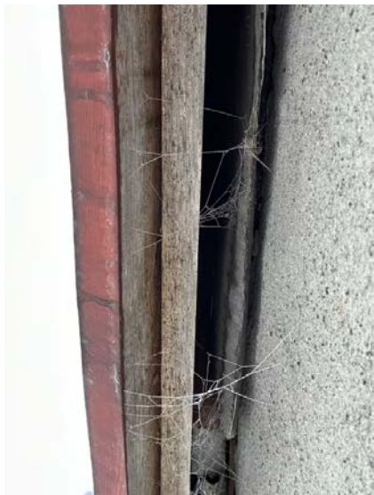
Viser lufting av kledningen. Det er ikke registrert bruk av musetetting mellom kledning og veggkonstruksjon.
