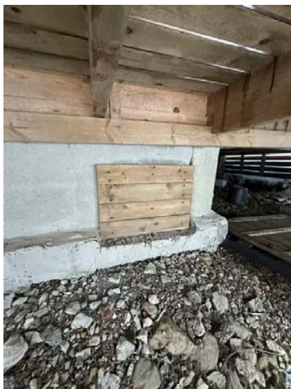
Åpningen til krypkjelleren er spikret igjen.
