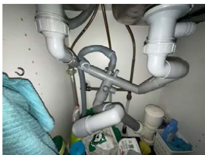
Viser vann og avløpsinnstallasjoner under kum.
