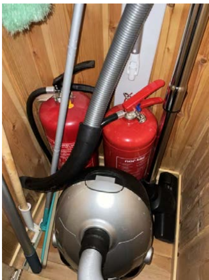
Viser 2 stk brannslukningsapparater.
