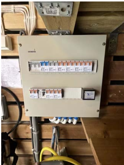
Viser sikringsskap plassert i bod.
