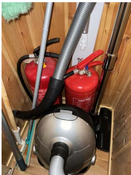
Viser 2 stk brannslukningsapparater.
