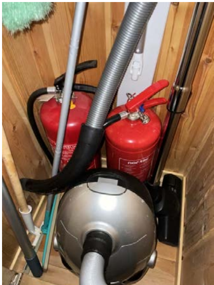
Viser 2 stk brannslukningsapparater.
