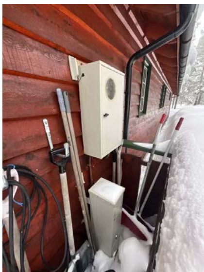
Viser inntaksskap og målerskap utvendig.
