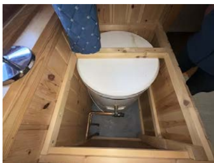
Viser bereder plassert i kasse på badet.
