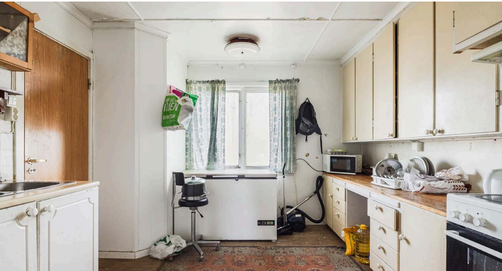
Kjøkken i 2. etasje med omfattende skader.
