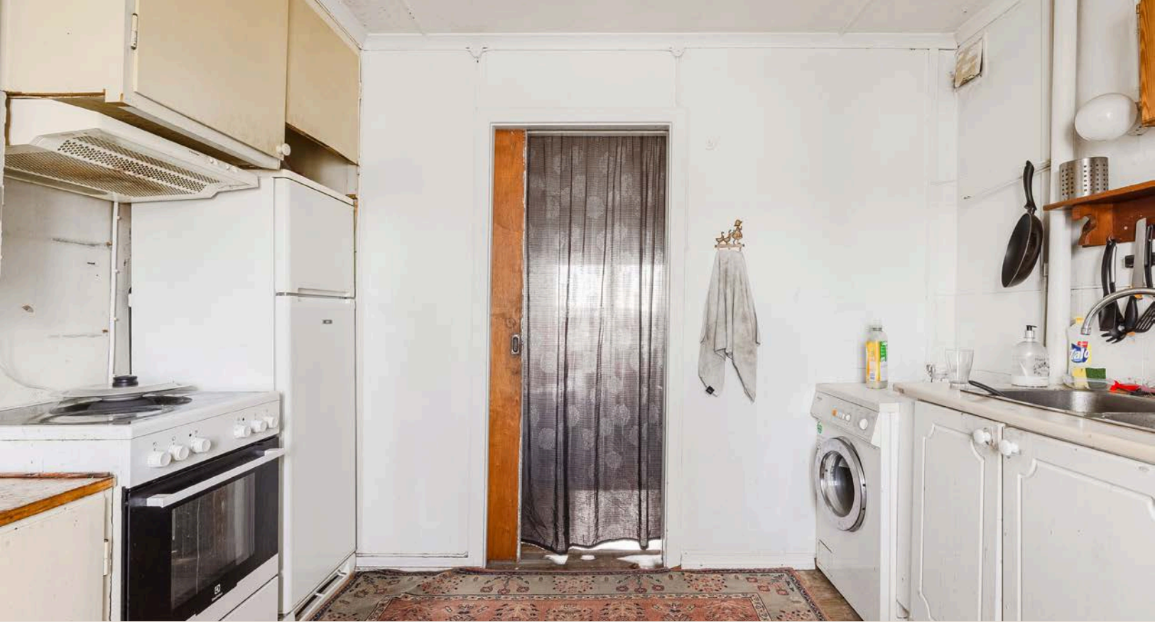
Det må foretas full utskifting av overflater/innredning.
