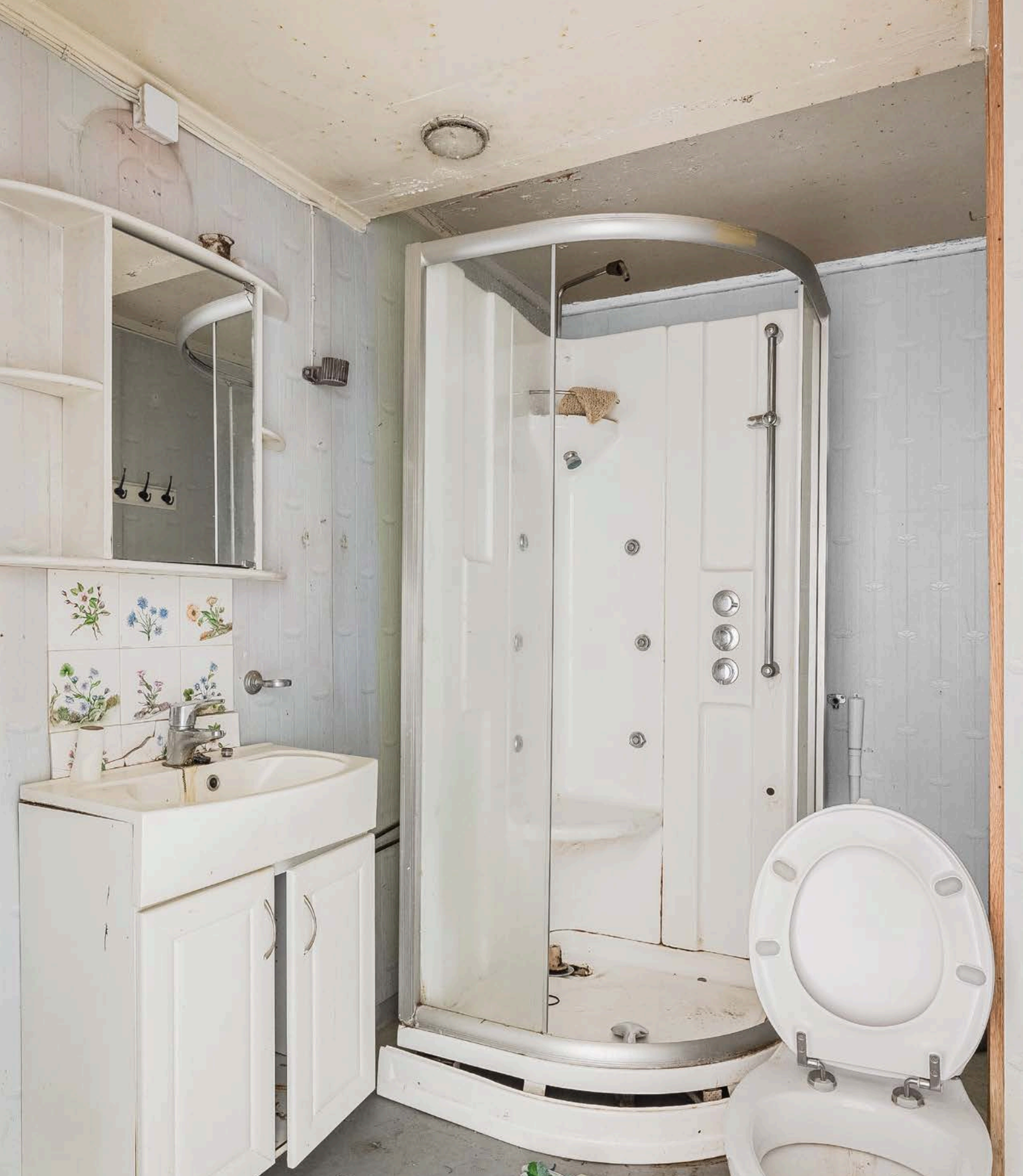
Eldre badrom i 1. etasje som må totalrenoveres.
