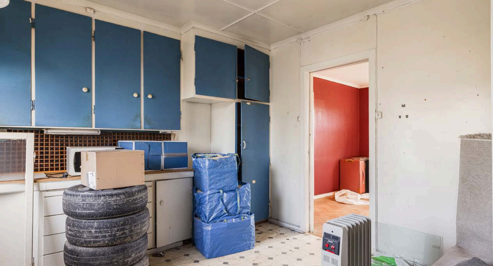
Huset må betraktes som ett totalt rehabiliteringsobjekt.
