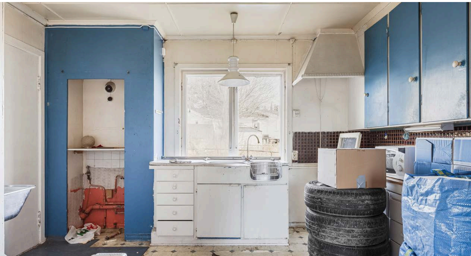
Kjøkkenet i 1. etasje med omfattende skader og behov for full utskifting av overflater/innredning.
