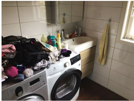
Innredning med vask og opplegg til vaskemaskin.
