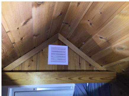
Eksempel på montert ventil i vegg.
