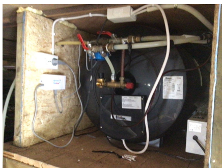
Varmtvannstank under hytte, montert i kasse.
