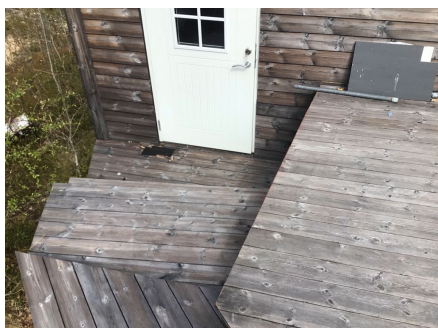
Eksempel på høyde over 50 cm som ikke er sikret med rekkverk.
