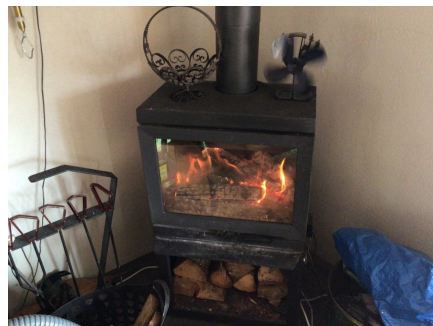
Montert ovn i stuen.
