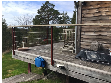
Del av terrasse, her ser man rekkverk med åpninger over 10 cm.
