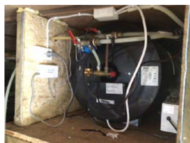
Varmtvannstank under hytte, montert i kasse.
