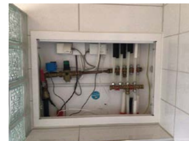
Skap til vannrør, her er også stoppekran.
