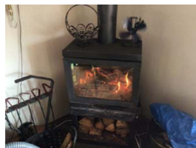
Montert ovn i stuen.
