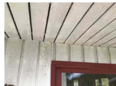
Del av vegg med eldre kledning, denne delen av vegg får TG:2.
