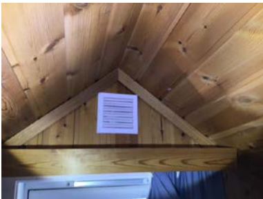
Eksempel på montert ventil i vegg.
