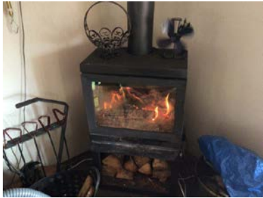
Montert ovn i stuen.
