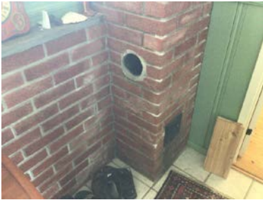
Pipe, uten montert ildsted.
