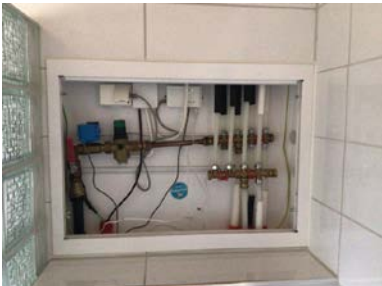
Skap til vannrør, her er også stoppekran.
