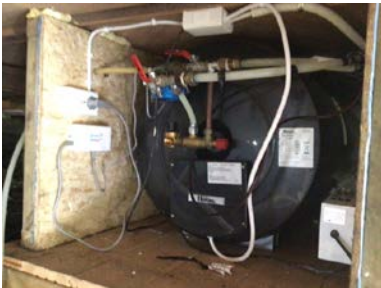
Varmtvannstank under hytte, montert i kasse.
