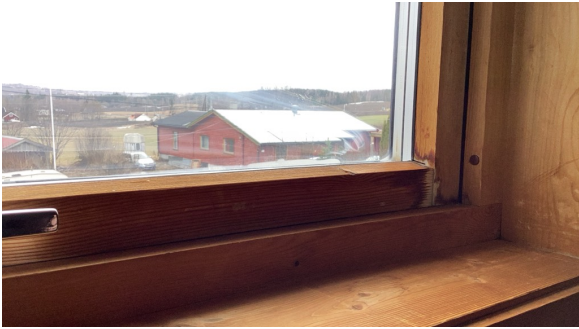
Kondensmerker og punktert vindu registrert.
