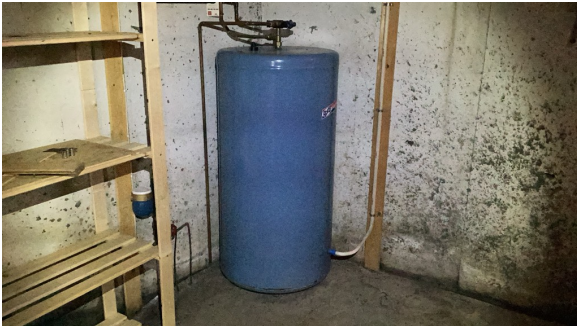
Varmtvannstank i kjeller.
