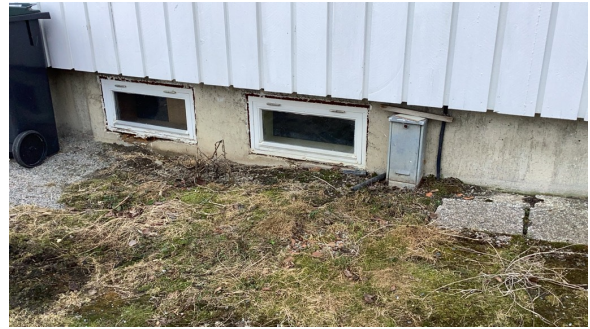
Lav høyde mellom terreng og kjellervinduer.
