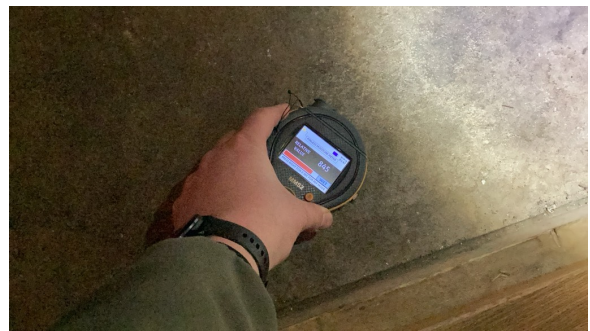
Ved enkle fuktsøk med fuktindikator registrerte jeg unormale verdier.
