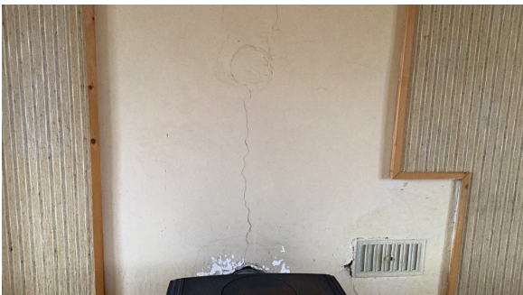
Sprekk i pipe.
