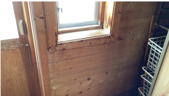
Fuktmerker rundt vindu.
