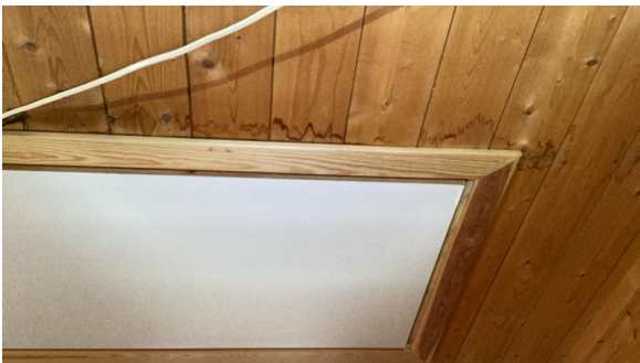
Fuktmerker rundt lofts luke.
