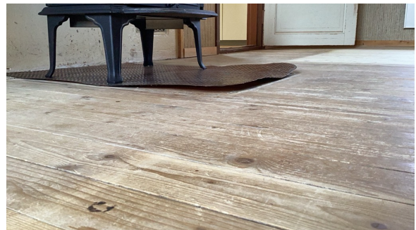
Plate ved ovn er ikke festet til gulv.
