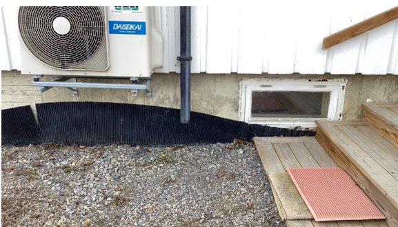
Mangler bortledning av takvann.
