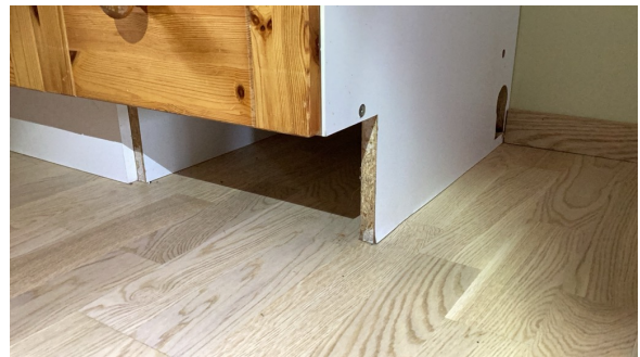
Mangler sokkel på deler av innredning.
