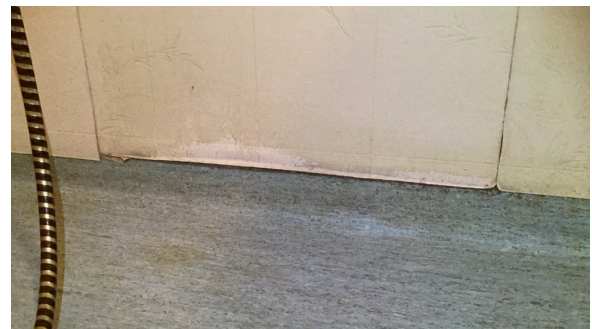
Løst belegg på vegger.
