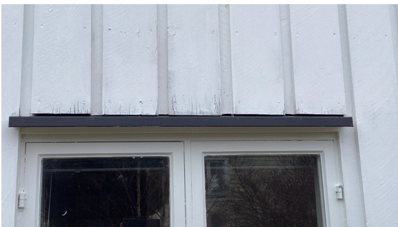
Deler av kledning bærer preg av slitasje.
