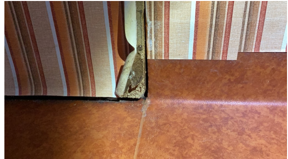
Fuktskader på plater.
