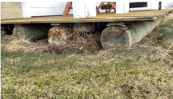
Rundstokker under terrasse kan inneholde kreosot. Noe som går som farlig avfall.
