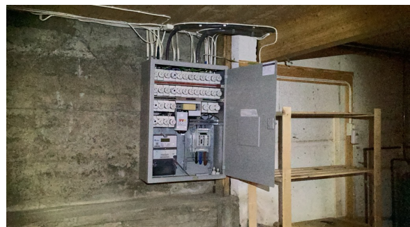
Sikringskap i kjeller.
