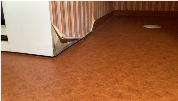
Fuktskader på plater.
