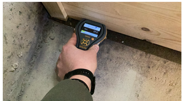
Fuktmåling ble foretatt, jeg målte grenseverdier for skadelig fukt og dette er en indikasjon på at konstruksjon er utsatt for fuktpåkjøring.
