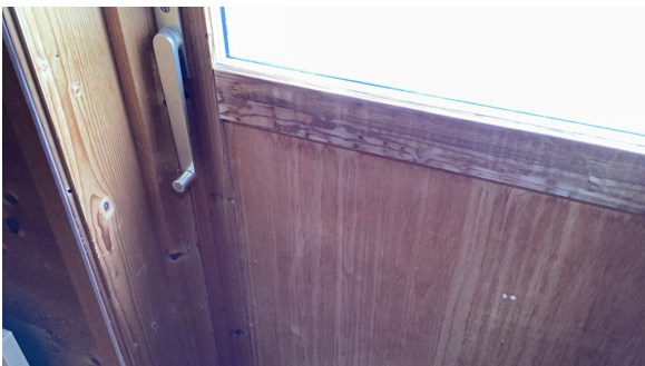
Fuktmerker på dør.
