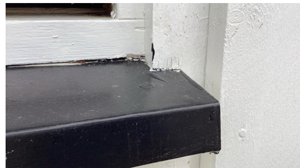
Kledning er ført ned på vannbrett, risiko for fuktopptrekk.
