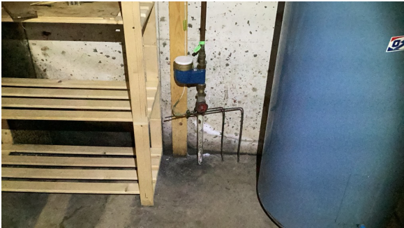
Vanmåler og stoppekran i kjeller.
