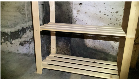
Misfarging på vegg.
