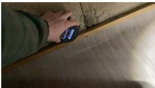
Ved enkle fuktsøk med fuktindikator registrerte jeg unormale verdier.
