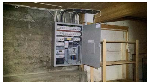
Sikringsskap i kjeller.
