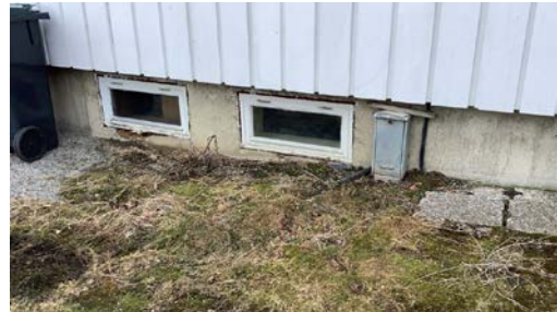
Lav høyde mellom terreng og kjellervinduer.
