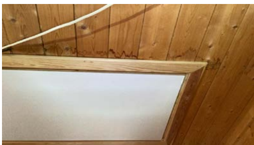
Fuktmerker rundt lofts luke.
