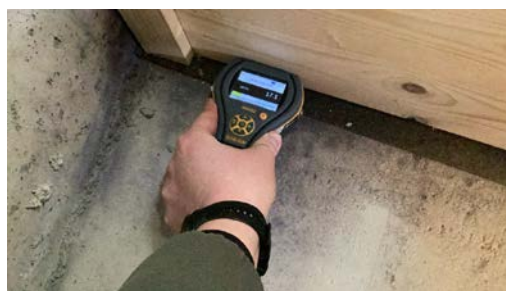
Fuktmåling ble foretatt, jeg målte grenseverdier for skadelig fukt og dette er en indikasjon på at konstruksjon er utsatt for fuktpåkjenning.
