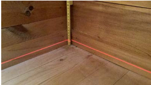
Helningsavvik på 22 mm blå målt på stue i loftsetasje.
