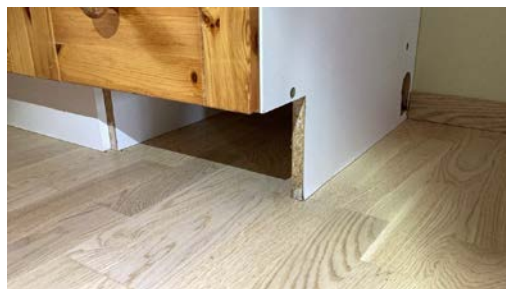
Mangler sokkel på deler av innredning.
