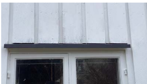
Deler av kledning bærer preg av slitasje.
