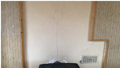
Sprekk i pipe.
