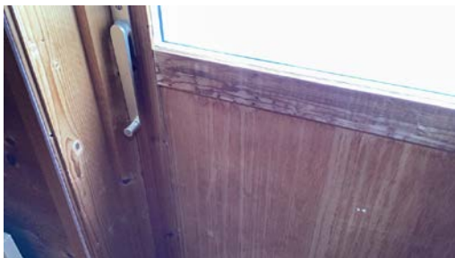
Fuktmerker på dør.
