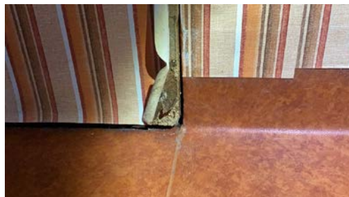
Fuktskader på plater.
