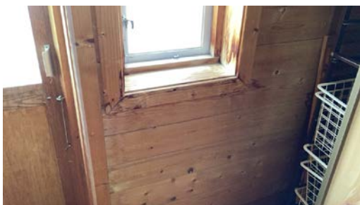
Fuktmerker rundt vindu.
