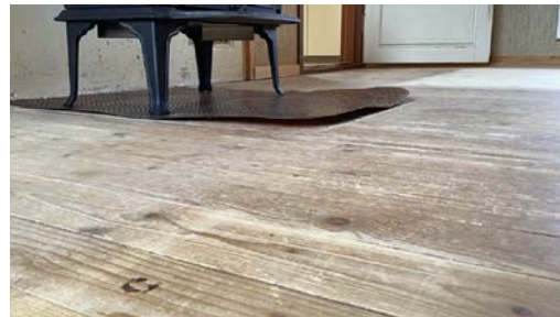
Plate ved ovn er ikke festet til gulv.
