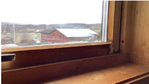
Kondensmerker og punktert vindu registrert.
