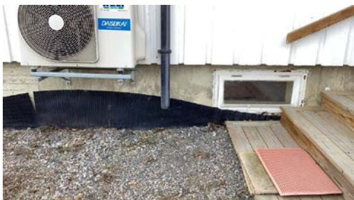
Mangler bortledning av takvann.
