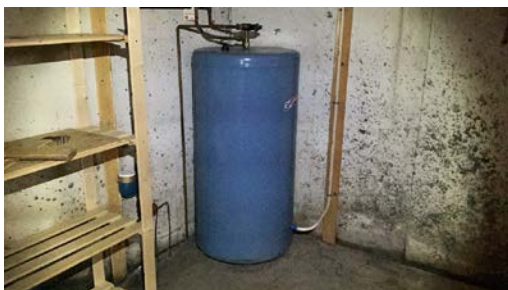
Varmtvannstank i kjeller.
