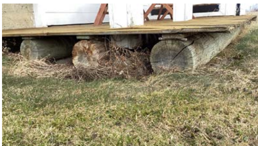
Rundstokker under terrasse kan inneholde kreosot. Noe som går som farlig avfall. Skjevheter registrert.
