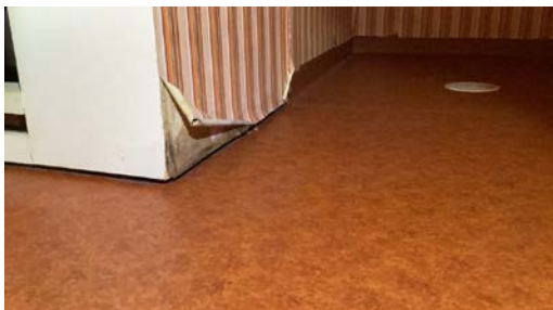
Fuktskader på plater.
