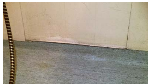
Løst belegg på vegger.
