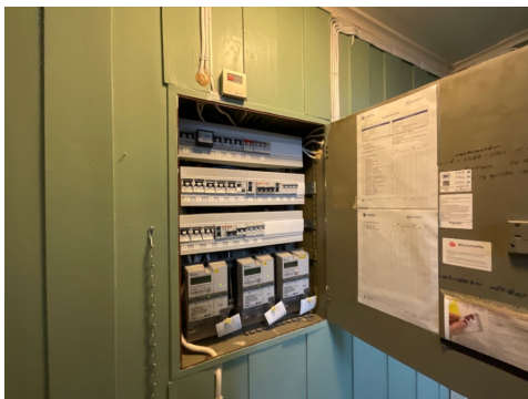
Sikringsskap i felles trappegang
