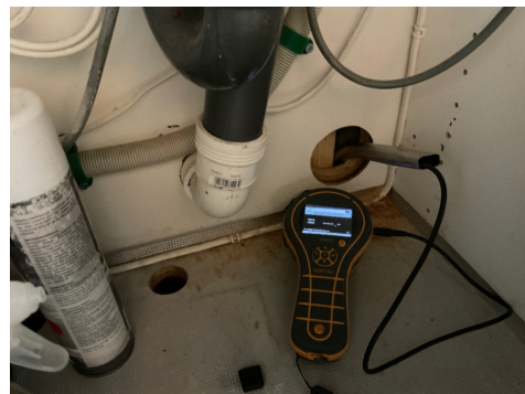
Fuktmåling i kjøkkenvegg 10. mars 2026
