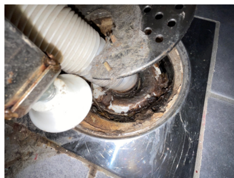
Sluk under dusjkabinett
