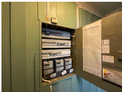
Sikringsskap i felles trappegang
