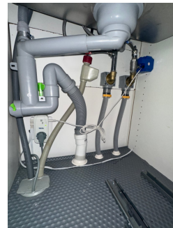
Røropplegg i kjøkkenbenk med Waterguard
