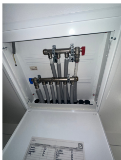
Samleskap med rørkurser og stoppekraner
