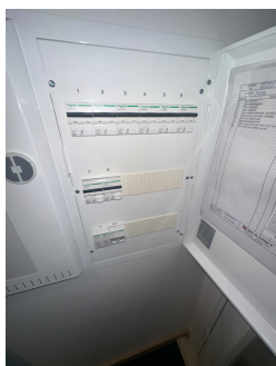
Sikringsskap med automatsikringer.
