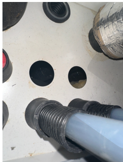
Manglende tettehylser i samleskap.
