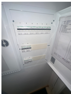
Sikringsskap med automatsikringer.
