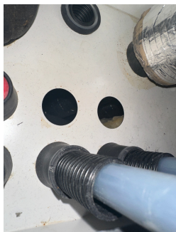
Manglende tettehylser i samleskap.
