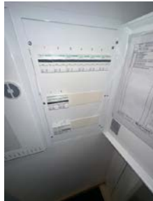
Sikringsskap med automatsikringer.
