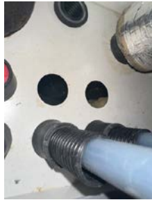
Manglende tettehylser i samleskap.
