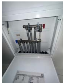
Samleskap med rørkurser og stoppekraner
