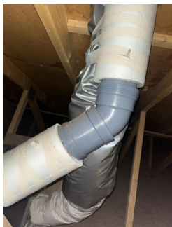
Soil (lufting kloak) er mangelfullt isolert, denne bør isoleres for å unngå kondens.
