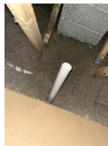
Rør for utluft sentralstøvsuger må føres ut av takkonstruksjonen.
