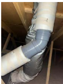
Soil (lufting kloak) er mangelfullt isolert, denne bør isoleres for å unngå kondens.
