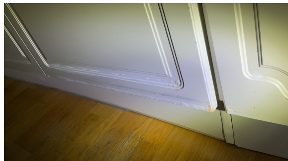
Fuktskader i dørfronter ved oppvaskkum.
