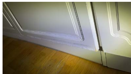
Fuktskader i dørfronter ved oppvaskkum.
