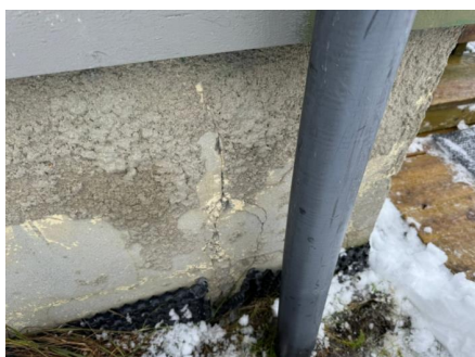
Eksempel på utvendig riss/sprek i grunnmuren.
