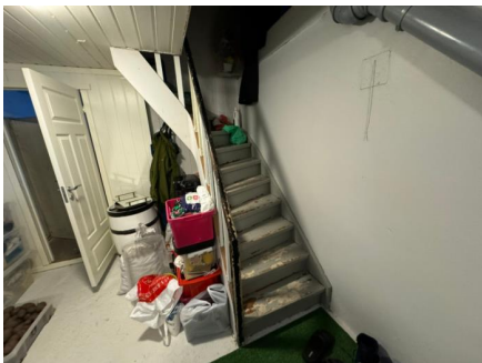
Eksempel på manglende håndløper.
