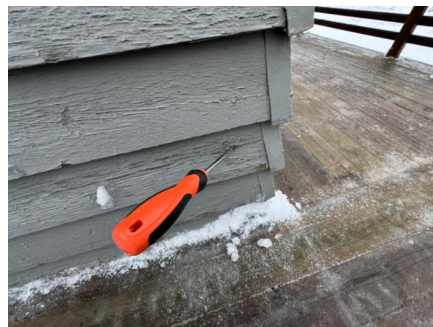
Eksempel på råteskadet kledning.
