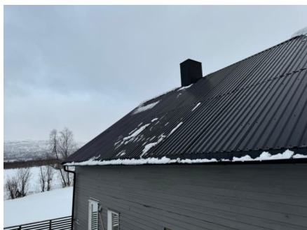
Manglende snøfangere hvor folk kan ferdes.
