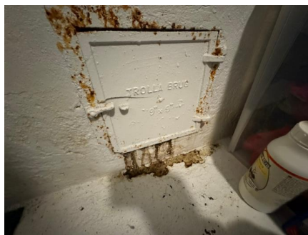
Skadet sotluke som sitter fast.
