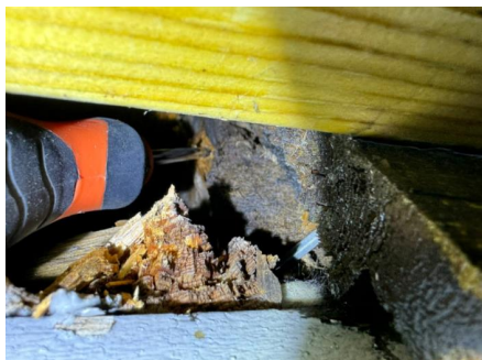
Råteskadet trevirke i konstruksjonen.
