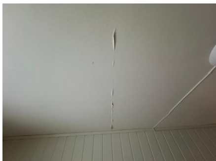
Eksempel på skade.
