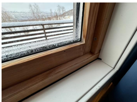
Fuktighet i vinduet.
