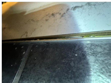
Dårlig fuget i nedkanten.
