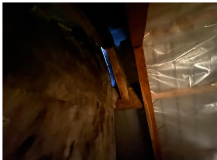
Manglende mansjett rundt pipen.
