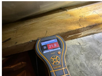
Fuktmåling ved pipen.
