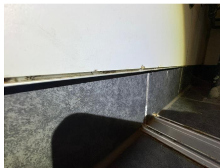
Skader i nedkanten av baderomsplaten.
