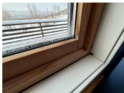
Innvendig kondensering på vindu.
