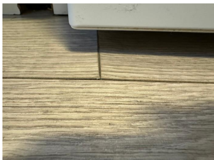
Fuktsvelling på kjøkkengulvet.
