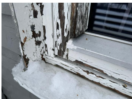
Værslitt vinduskarm, manglende oppbrett på beslag.
