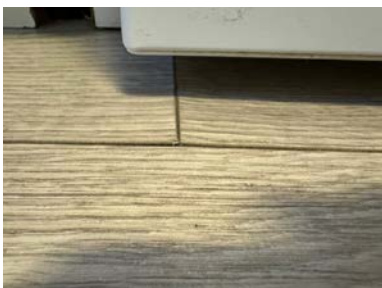
Fuktsvelling på kjøkkengulvet.
