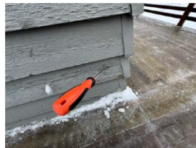
Eksempel på råteskadet kledning.
