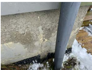
Eksempel på utvendig riss/sprekk i grunnmuren.
