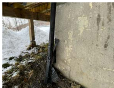
Eksempel på utvendig riss/sprekk i grunnmuren.
