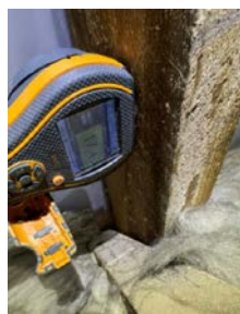
Fuktmåling nede på takspærren.
