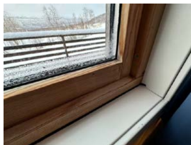
Innvendig kondensering på vindu.
