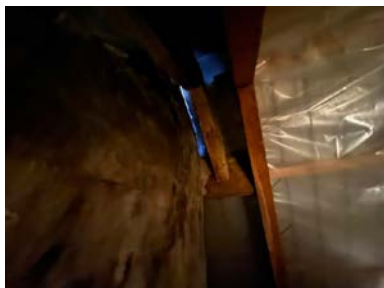
Manglende mansjett rundt pipen.
