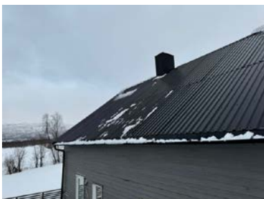
Manglende snøfangere hvor folk kan ferdes.
