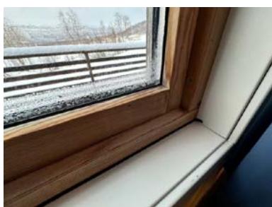
Fuktighet i vinduet.
