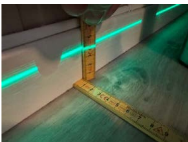
Måling ved kneveggen.
