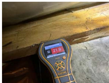
Fuktmåling ved pipen.
