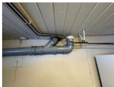
Vakumventil i kjelleren.
