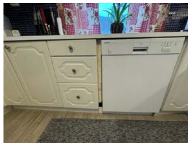
Eksempel på skade som er utover hva man kan forvente.
