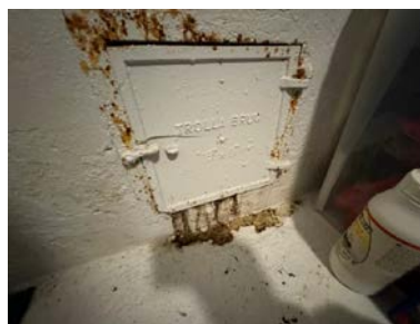
Skadet sotluke som sitter fast.
