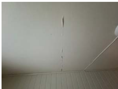
Eksempel på skade.
