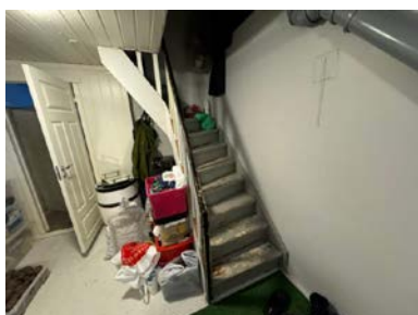
Eksempel på manglende håndløper.
