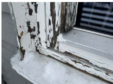
Værslitt vinduskarm, manglende oppbrett på beslag.
