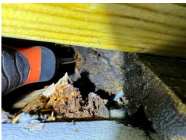
Råteskadet trevirke i konstruksjonen.
