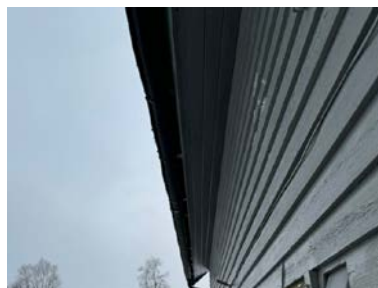
Skader på takrennen.
