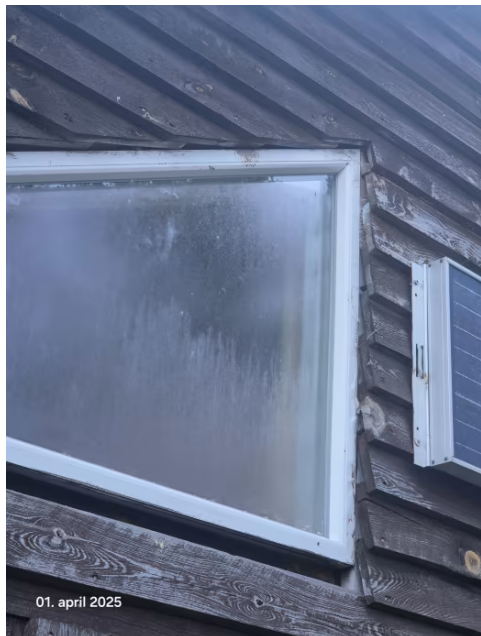
Manglende belistning og vannbord.
