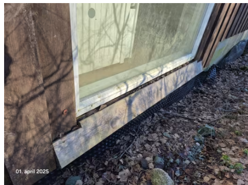
Vannbord som har løsnet. Ufagmessig utførelse.
