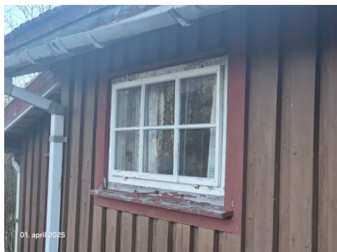
Vindu i opprinnelig del av hytta. Værslitt.
