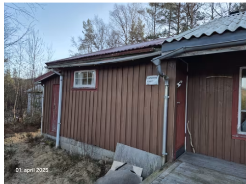
Skjevhet i takrenne.
