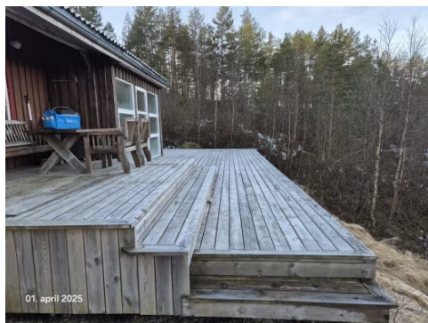
Bildet viser terrassen, og manglende rekkverk.
