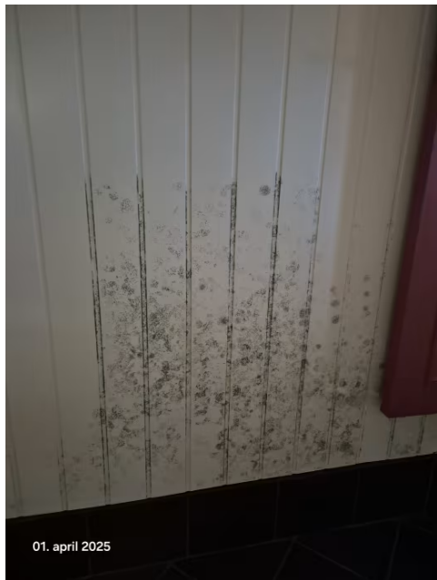
Soppvekst på veggen på badet.
