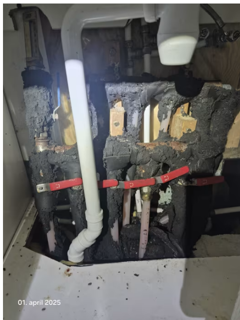
Musespist isolasjon, og rust på fordeler.
