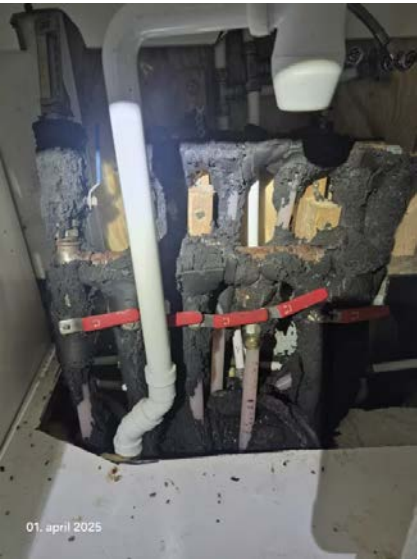
Musespist isolasjon, og rust på fordeler.
