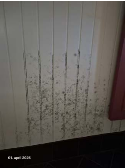
Soppvekst på veggen på badet.
