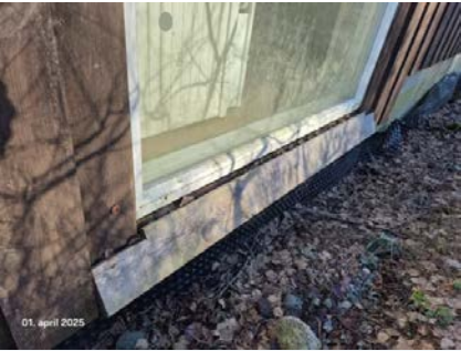
Vannbord som har løsnet. Ufagmessig utførelse.
