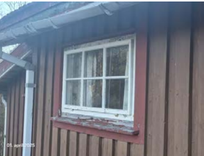
Vindu i opprinnelig del av hytta. Værslitt.
