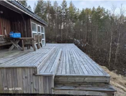
Bildet viser terrassen, og manglende rekkverk.
