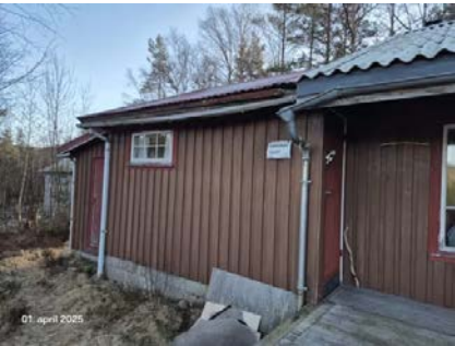
Skjevhet i takrenne.
