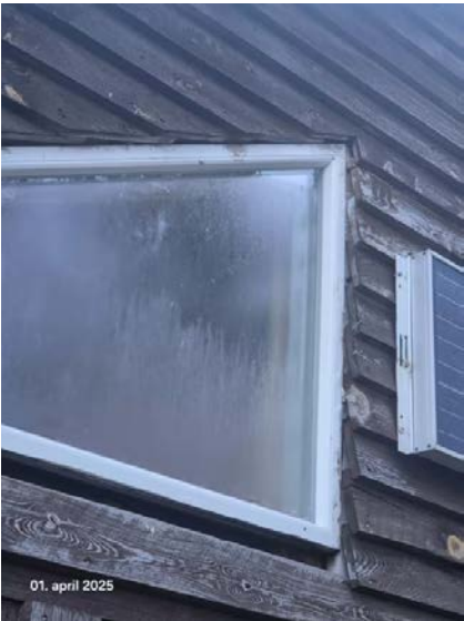
Manglende belistning og vannbord.
