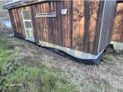
Bildet viser grunnmursplast som ikke er ferdigstilt.
