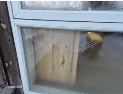
Sprukket glass, i den påbygde delen av hytta.
