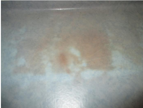
Merker på gulvbelegget.
