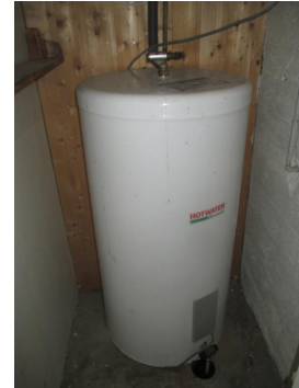
Bereder er plassert i et kott i kjellerstue.
