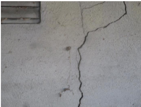
En sprekk i ringmur av lecablokker.
