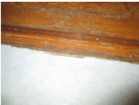
Skader på belegget ved dørsvill.
