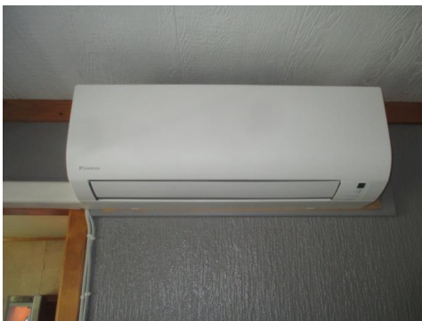
Varmepumpe i stue.
