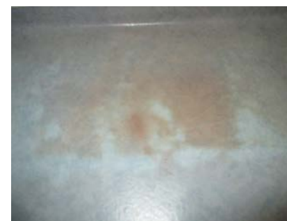
Merker på gulvbelegget.
