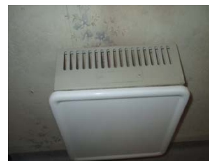
Panelovn på veggen.
