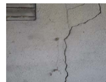
En sprekk i ringmur av lecablokker.
