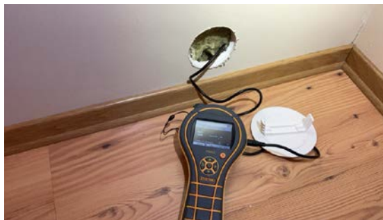
Hulltaking er foretatt fra alkove, ved fuktmåletking var det ikke fuktutslag
