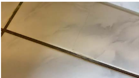
Sprekkdannelse i en flis, bør holdes under tilsyn
