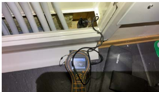
Fuktmåletaking er foretatt fra åpning i vegg i bod mot dusj, av stender ved dusj var det ikke fuktutslag
