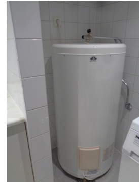
Varmtvannsbereder på badet.
