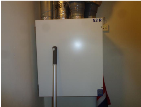
Balansert ventilasjonsanlegg i bod.
