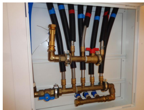
Rør i rør sentral i himling i badet.
