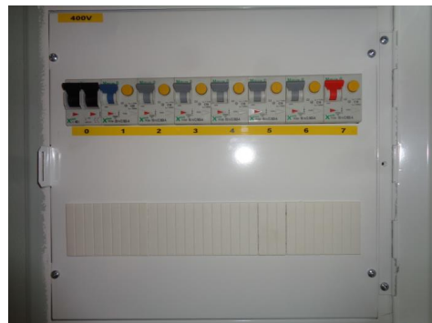
Sikringsskap i entrè.
