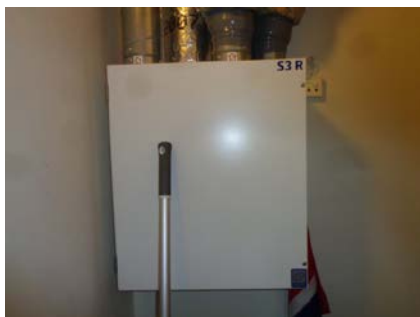
Balansert ventilasjonsanlegg i bod.
