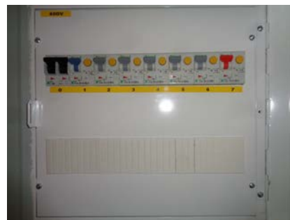
Sikringsskap i entrè.
