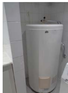
Varmtvannsbereder på badet.
