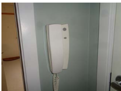
Dørtelefon i entré.
