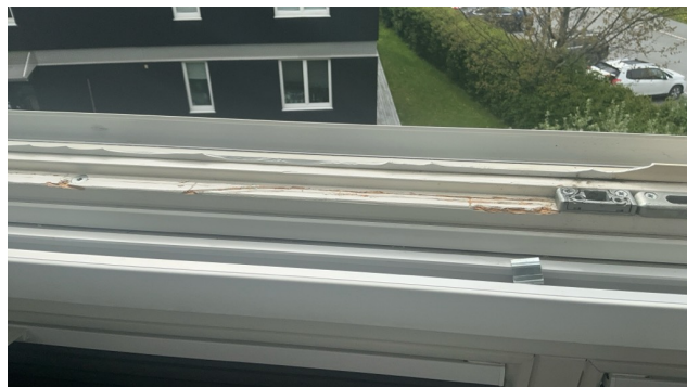
Skader i karm.
