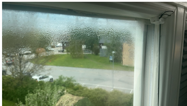
To vinduer er synlig punktert.
