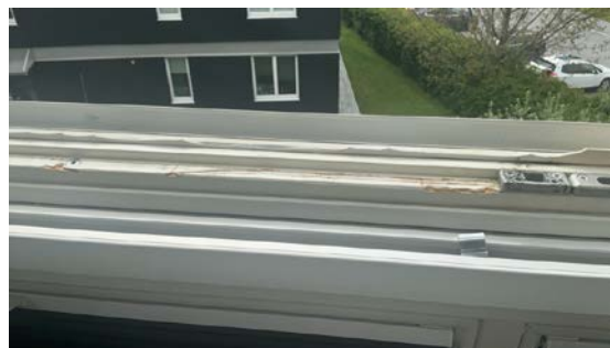
Skader i karm.
