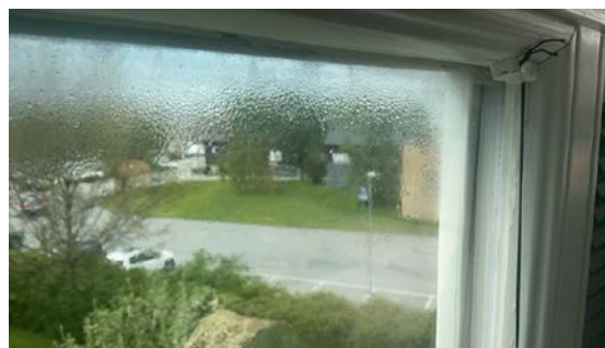
To vinduer er synlig punktert.
