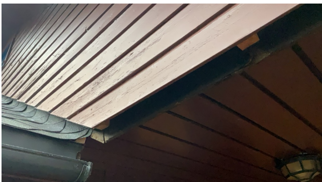
Åpninger og ufagmessighet registrert mot veggkonstruksjon
