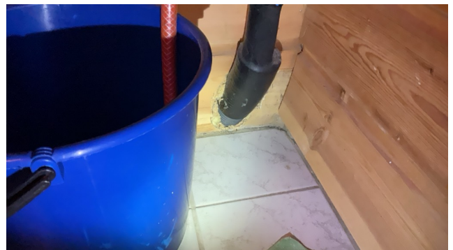
Overgang vannledning gjør til gjennomføring er i våtsone der tettesjikt er kappet nedtil gulv
