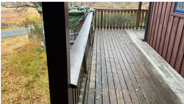
Skjevheter i rekkverk
