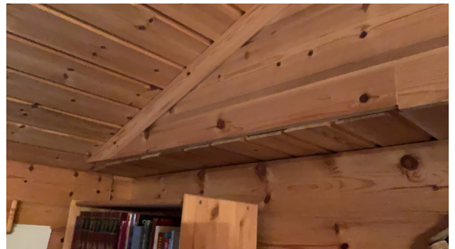
Stedvis manglende finish arbeid
