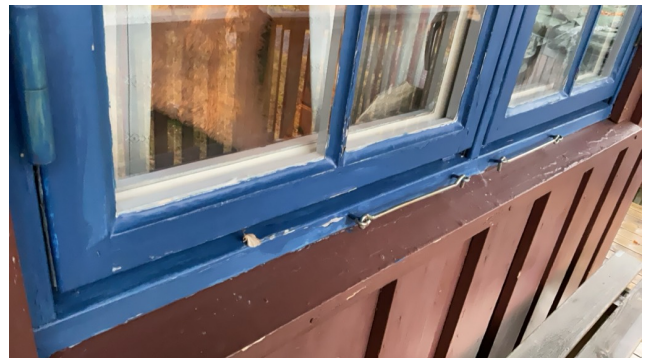
Vedlikeholdsbehov av vinduer
