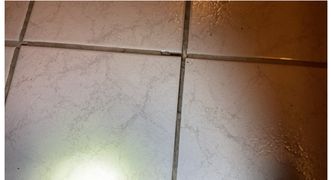
Bom (hullrom) med løse fliser og sprekker i fuger
