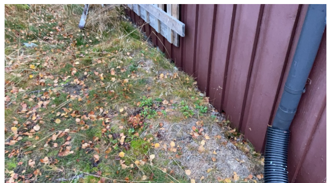
Terrengjustering/fall bør endres, samt avstand fra yttervegg og terreng bør være større for å unngå fuktpåkjenning
