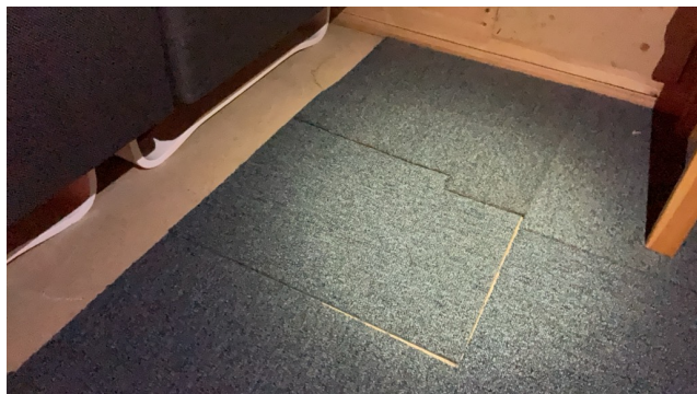
Løse teppefliser over sponplategulv, ikke fagmessig utførelse der gulv er løst, mangler stedvis og ikke tilstrekkelige overganger
