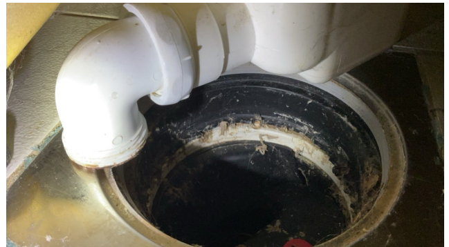
Fra sluk ble ikke tettesjikt registrert under klemring
