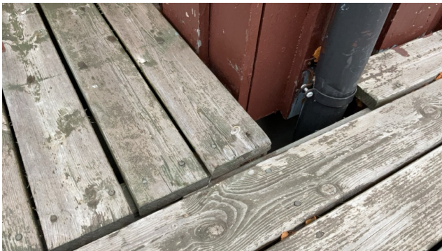
Avvik på terrassegulv og vedlikeholdsbehov
