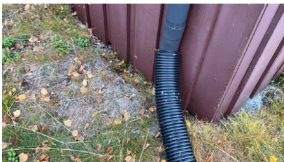
Yttervegg ligger stedvis nært terreng med fare for fuktpåkjenning
