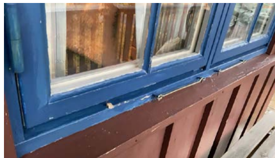
Vedlikeholdsbehov av vinduer
