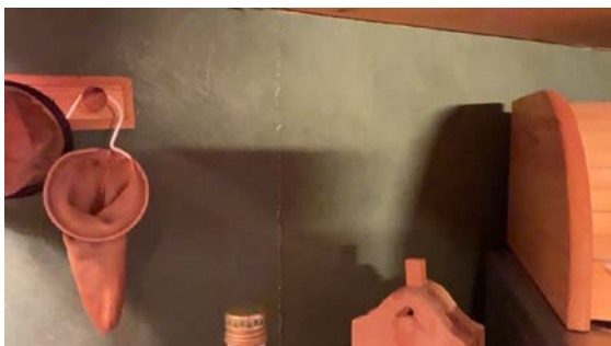
Sprekke dannelse i plateskjøt på tapet
