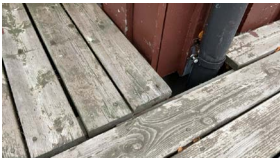
Avvik på terrassegulv og vedlikeholdsbehov
