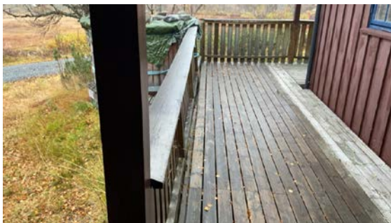
Skjevheter i rekkverk
