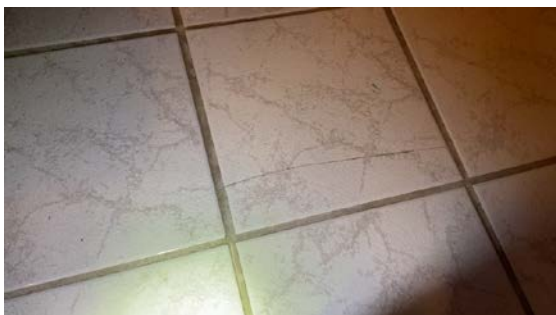
Sprekker i flis
