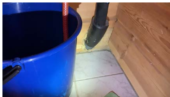
Overgang vannledning gjør til gjennomføring er i våtsone der tettesjikt er kappet ned til gulv
