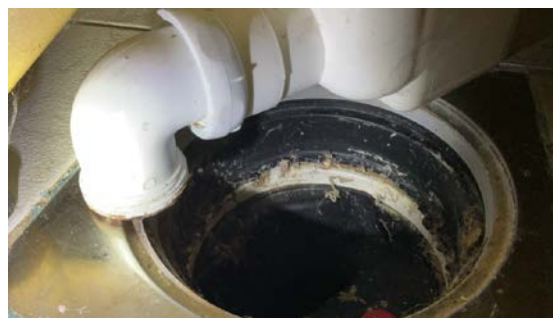
Fra sluk ble ikke tettesjikt registrert under klemring
