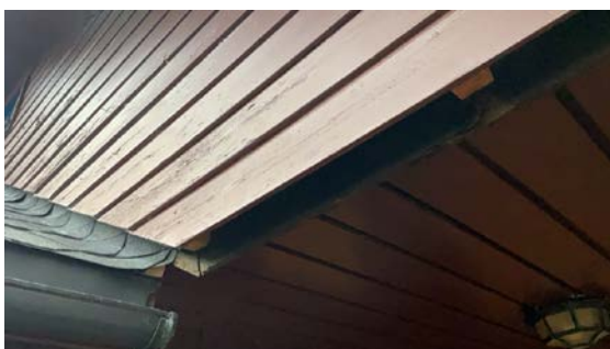
Åpninger og ufagmessighet registrert mot veggkonstruksjon
