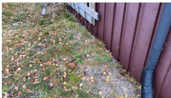
Terrengjustering/fall bør endres, samt avstand fra yttervegg og terreng bør være større for å unngå fuktpåkjenning
