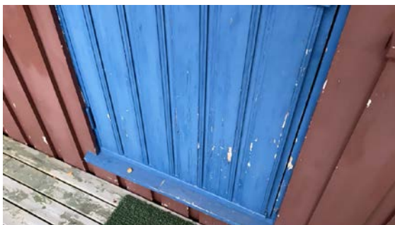
Vedlikeholdsbehov, spesielt av terrassedør
