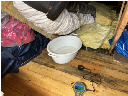
Oppsamling av kondensvann fra ventilasjonsrør.
