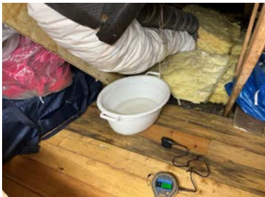
Oppsamling av kondensvann fra ventilasjonsrør.
