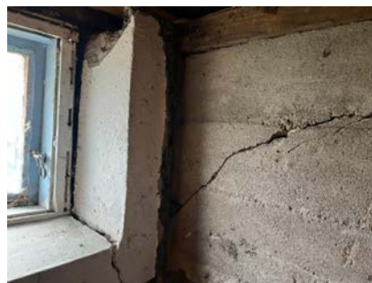
Skråriss i grunnmur
