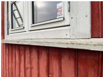
Manglende beslag, tetting under/over vinduer
