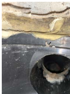
Manglende klemring og ikke membran på mansjett.
