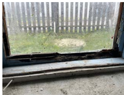
Store råteskader i vinduer i kjeller.
