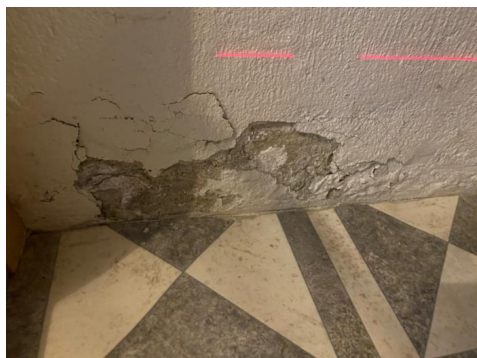
Kapilæroppslag (fukt fra grunn trekker opp i betongkonstruksjonen) påvist flere plasser i gangen i kjeller.
