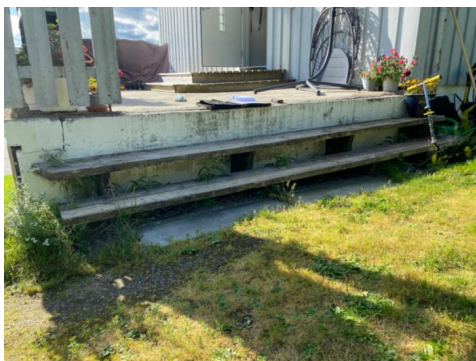
Trapp fra balkong.
