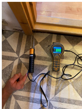
Fuktmåling i treverk mot tilfarergulv fra gangen i underetasjen. Forhøyde verdier.
