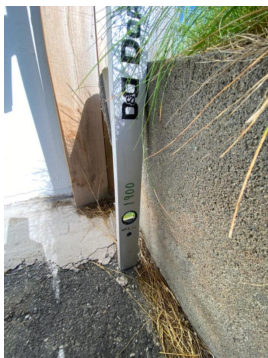
Støttemur mot garasje har store skjevheter.
