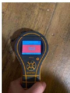
Fuktmåling mot gulv på lagerrom i underetasjen. Målingen viser store utslag.
