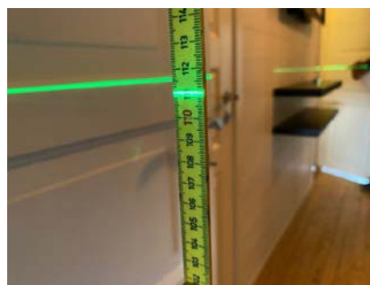
Måleavvik stue. Loftsetasjen.
