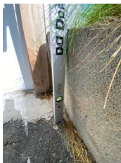
Støttemur mot garasje har store skjevheter.
