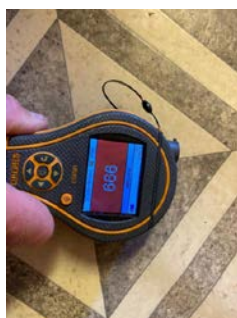
Fuktmåling mot gulv i gangen i underetasjen. Målingen viser store utslag.
