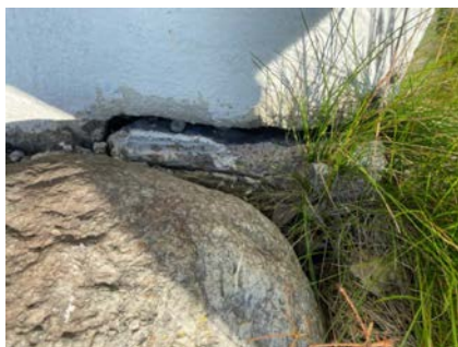
Stor sprekk i mur ved hjørne mot garasje.
