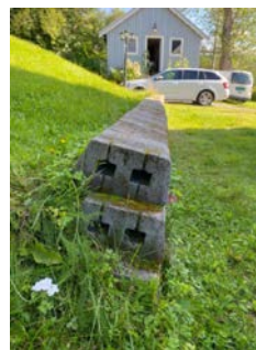
Store skjevheter i mur grunnet sig fra jordmasser.
