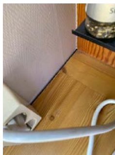
Det mangler fuging mot dekkside.
