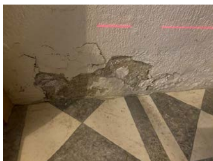
Kapilærøppsug (fukt fra grunn trekker opp i betongkonstruksjonen) påvist flere plasser i gangen i kjeller.
