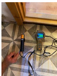
Fuktmåling i treverk mot tilfarergulv fra gangen i underetasjen. Forhøyde verdier.
