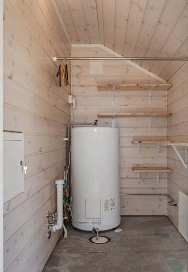
Til høyre for inngangsdøren er det adgang til en utvendig bod/teknisk rom på 3m 2 .
