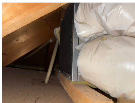
Ventilasjonssentral på loft
