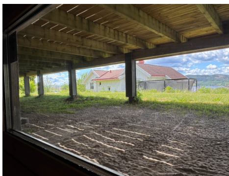
Motfall på terreng
