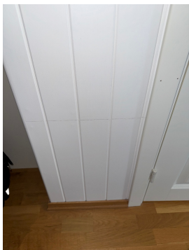
Synlige horisontal plateskjøter i 2.etg.
