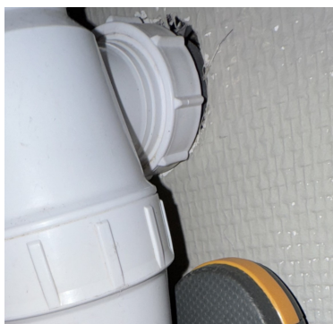
Rørgjennomføring vegg i utslagsvaskens våtsone.
