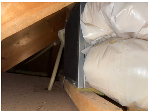
Ventilasjonsenhet på loft.
