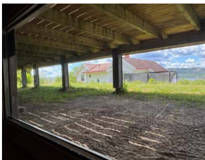
Motfall på terreng
