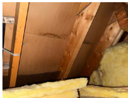
Gamle fuktmerker i undertak.
