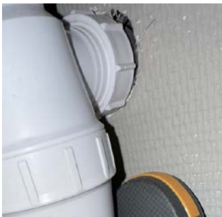
Rørgjennomføring vegg i utslagsvaskens våtsone.
