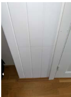
Synlige horisontal plateskjøter i 2.etg.
