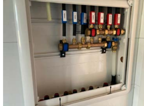
Fordelerskap med stoppekran på bad.
