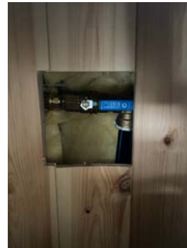
Stoppekran bak hjørneskap på kjøkken.
