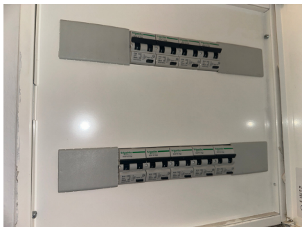
Sikringskap med automatsikringer.
