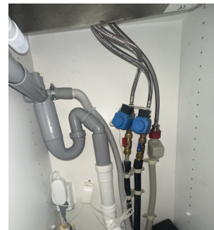
Røropplegg i kjøkkenbenk med Waterguard
