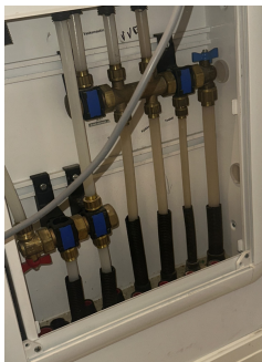
Samleskap med rørkurser og stoppekraner
