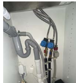
Røropplegg i kjøkkenbenk med Waterguard
