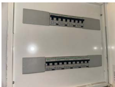
Sikringsskap med automatsikringer.
