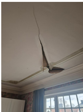
Skade i trekt strie himling med maskin papir.
