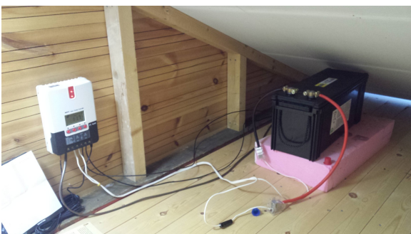
Laderegulator og batteri plassert på hemsen.
