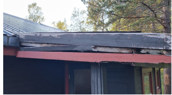
Råteskade i vindskibord.
