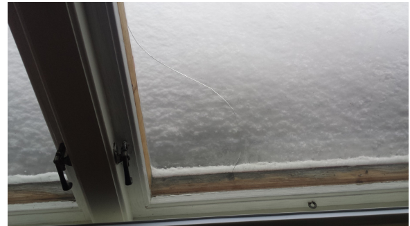
Skadet glass i det ene stuevinduet.
