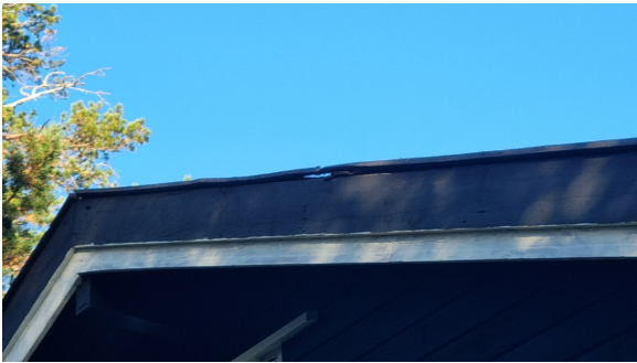
Råteskade i vannbord over vindskibord
