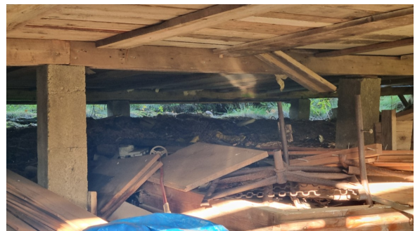
Skjevheter i enkelte peler.
