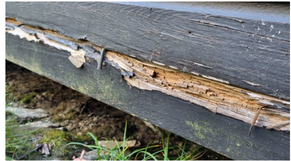
Råteskade i ytterkledning.
